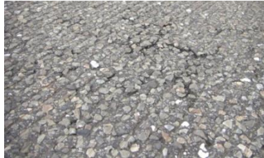
As成分の劣化と面状クラック
