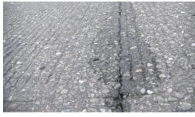
施工目地の開きと湧水跡
