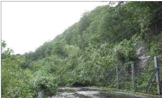
【表層崩壊箇所の現地状況】
