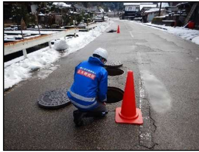
【被災施設の調査】
