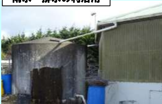
雨どいと雨水貯留タンク
