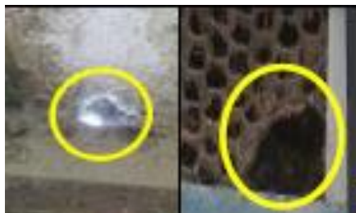
壁や金網の破損
