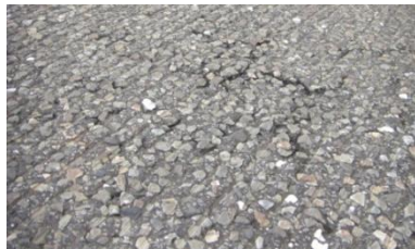
As成分の劣化と面状クラック
