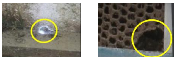
建物・設備の破損
